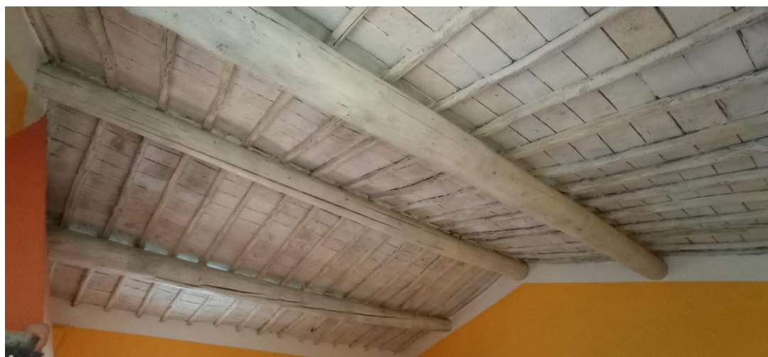
travatura tetto imbarcata e sottodimensionata
