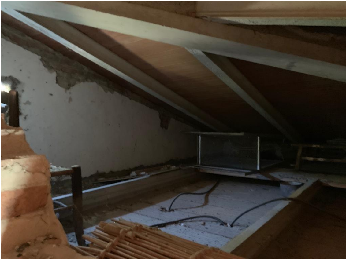
INTERNI DEL SOTTOTETTO E DELLA COPERTURA IN C.A. E TAVELLONI DI LATERIZIO
