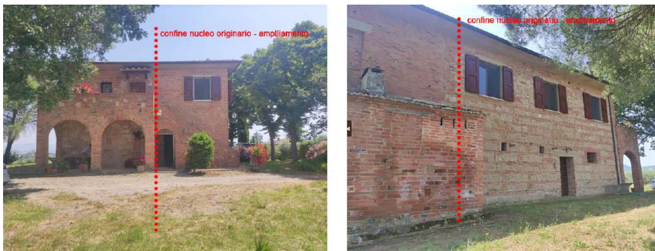
Figura 6 – foto con individuazione delle cesure tra il volume principale e successivi ampliamenti.
